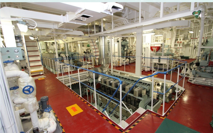
機関室(中段・カーゴエンジン側)
